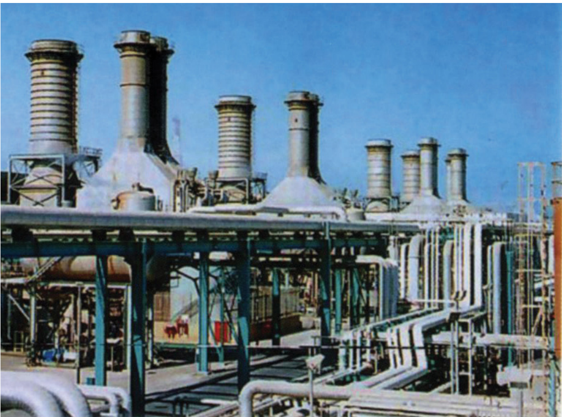
محطة تحلية مياه في قطر
