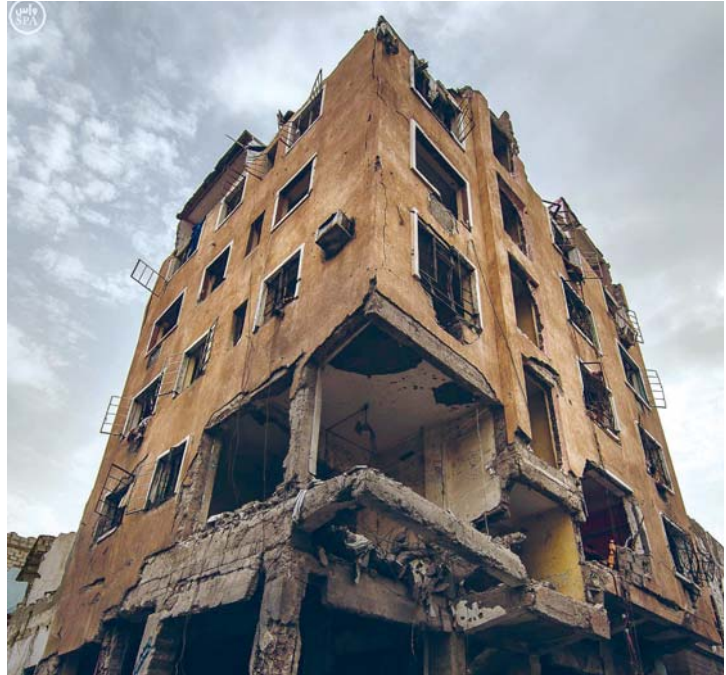
مبنى سكني دمره قصف الحوثيين على مدينة تعز | واس
